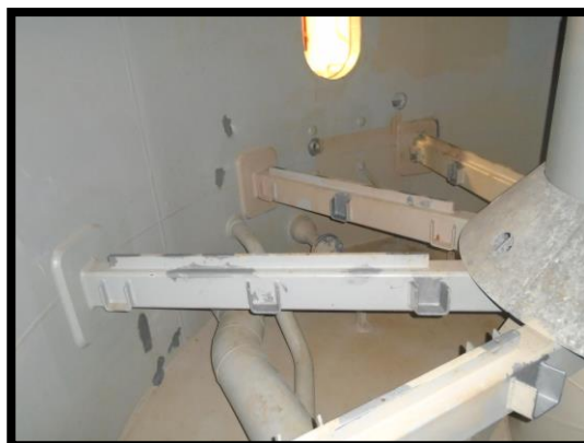
Figura 08 – Tanque de lama adaptado para cabos de poliéster
