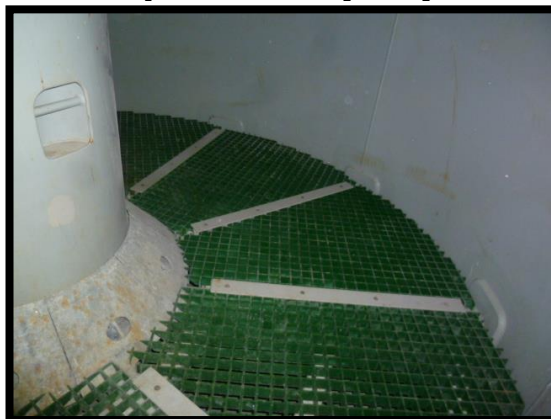
Figura 09 – Tanque de lama adaptado para cabos de poliéster
